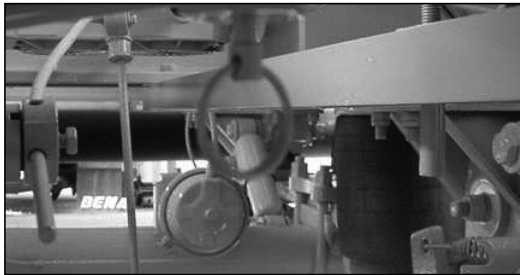
Fig. 43-1 : válvula de purga manual
