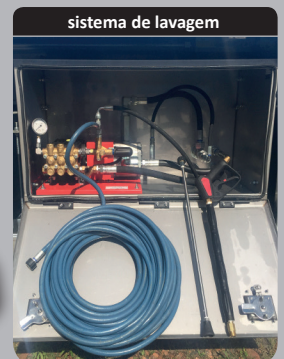
sistema de lavagem
